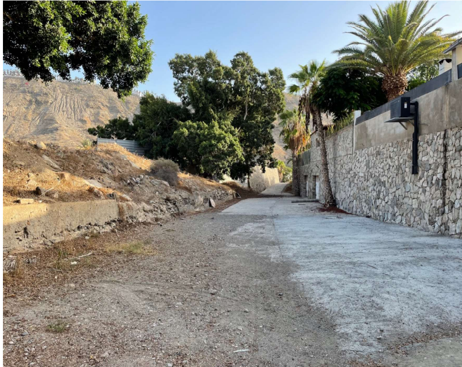
Aspecto del frente de la parcela P-62 dando al vial sin asfaltar prolongación de la Calle Austria.
